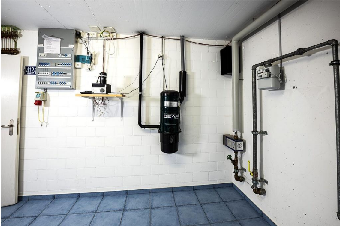
Technikraum mit Zentralstaubsauger und Granderfilter im UG
