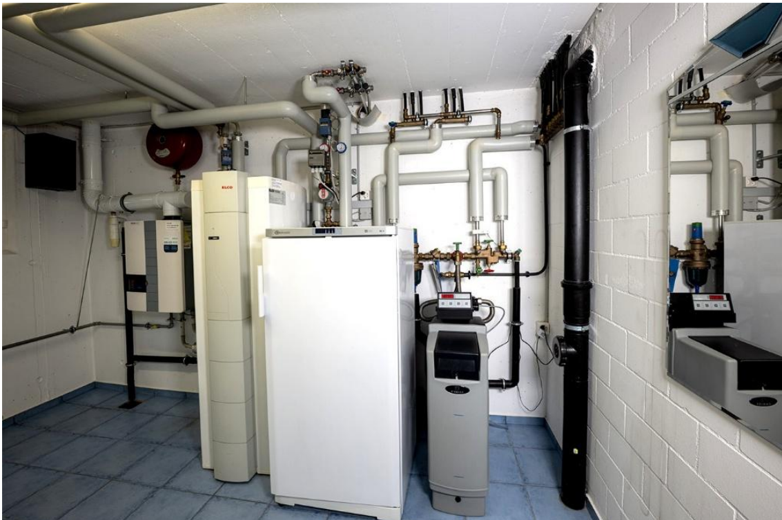
Technikraum mit Gasheizung, Boiler, Entkalkungsanlage (Salz) und Gefrierschrank im UG
