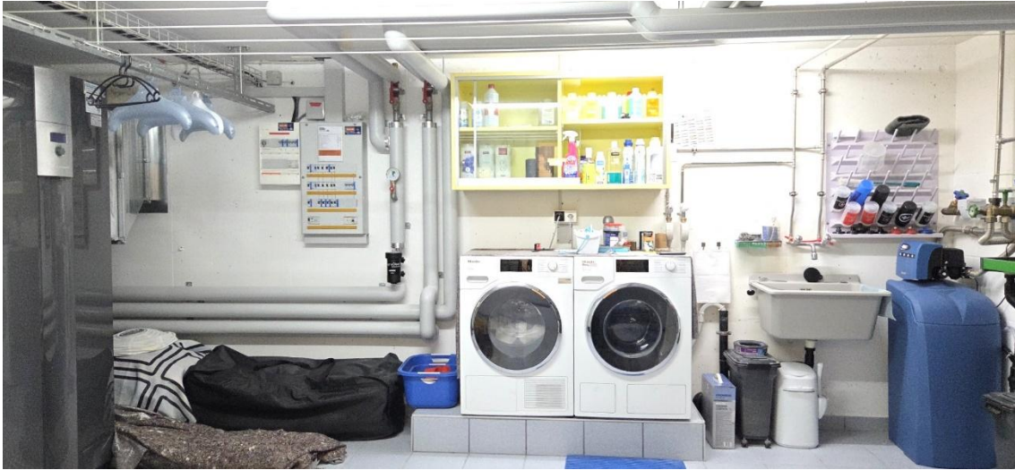
Waschraum mit Waschmaschine, Tumbler, Wärmepumpe, Boiler, Entkalkungsanlage und Lavabo im UG
