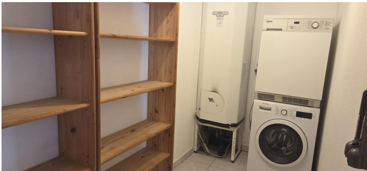
Abstellraum bei der Küche mit Waschmaschine, Tumbler und Boiler
